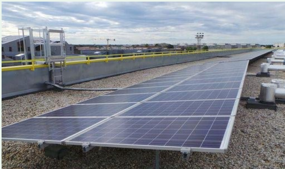
Toiture PV de la résidence Les Souffleurs à Bordeaux – Crédit : Gironde Habitat
